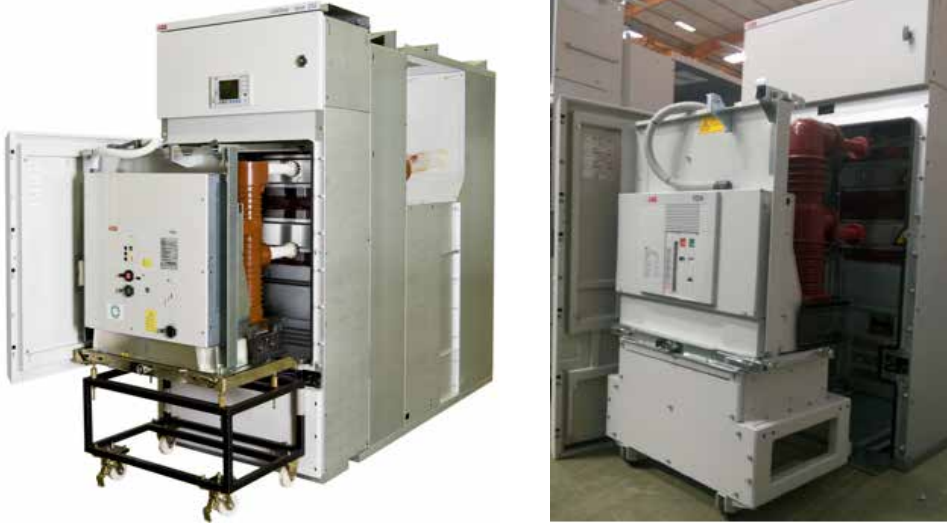
Şekil 11: AIS panolarda kesici görünüşleri.
